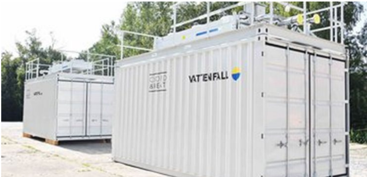
Abbildung 4: Versuchsrechenzentrum von Vattenfall in Fordbro
